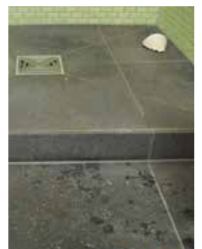
Stufe auf die Dusche Foto: PG
