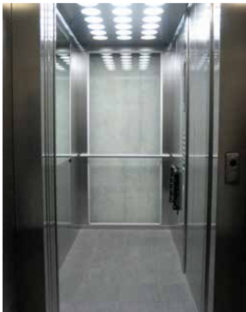
Aufzugskabine mit Festverglasung Foto: EM
